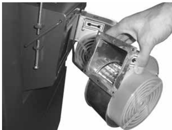
Sprawdzanie wentylatorów ciśnieniowych kotłów
